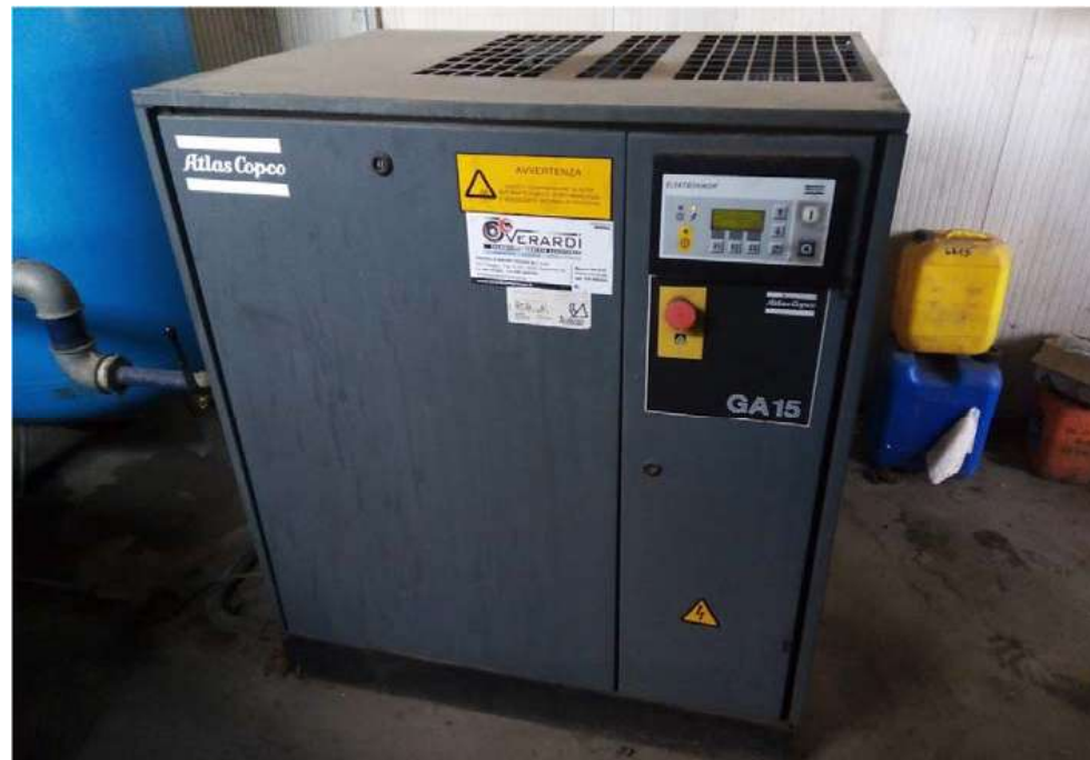
31 – Compressore ATLAS COPCO
