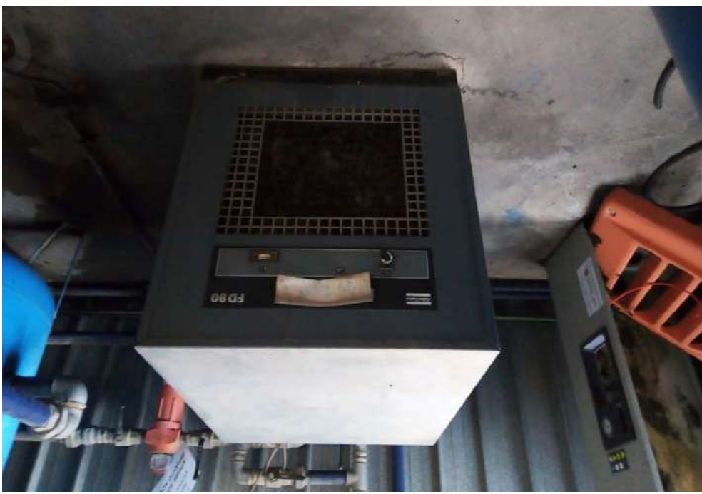
32 – Refrigeratore ATLAS COPCO
