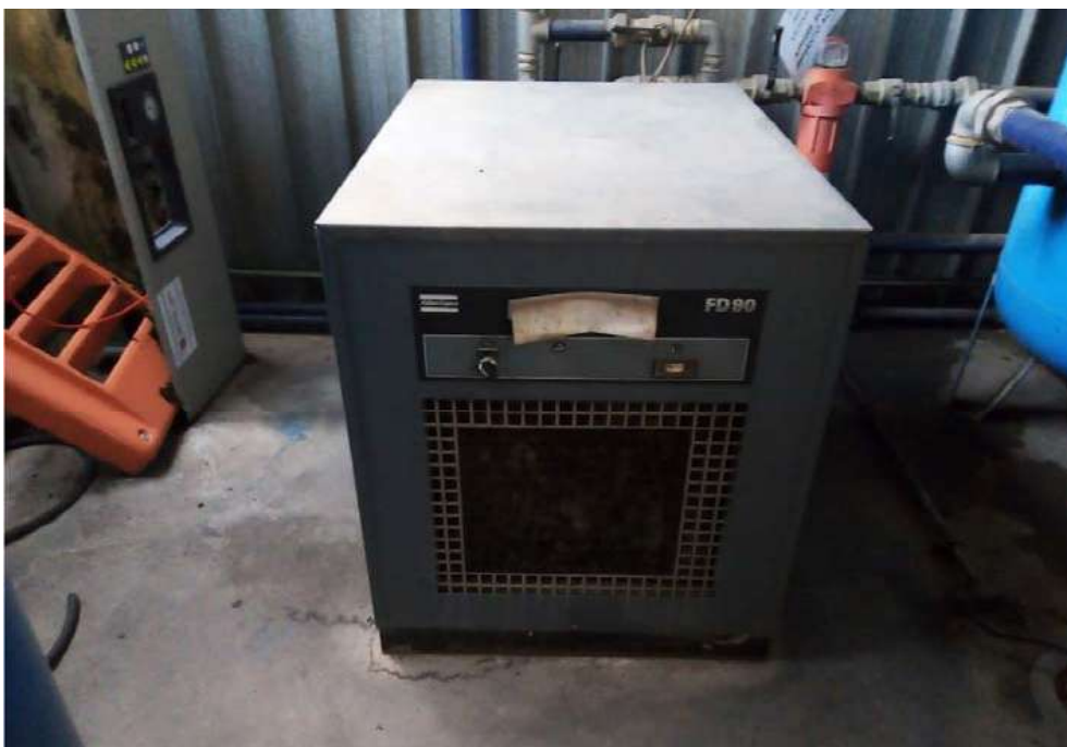
32 – Refrigeratore ATLAS COPCO
