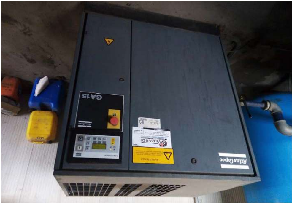
31 – Compressore ATLAS COPCO
